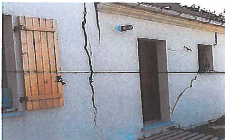
FOTO N • 1: Ejemplos de grietas en una casa
